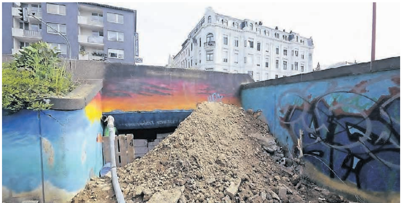
2008 wurde der Fußgänger-Tunnel am Robert-Daum-Platz mit Erde gefüllt.
