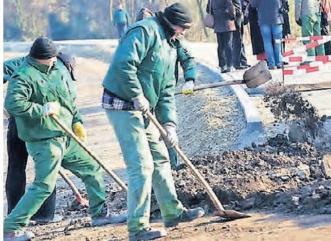
Bevor der wunderbare Radweg auf der Nordbahntrasse entstand, mussten viele Menschen schuften. Hier leisten die Mitarbeiter des Wichernhauses ganze Arbeit. Archiv-Foto: Uwe Schinkel
