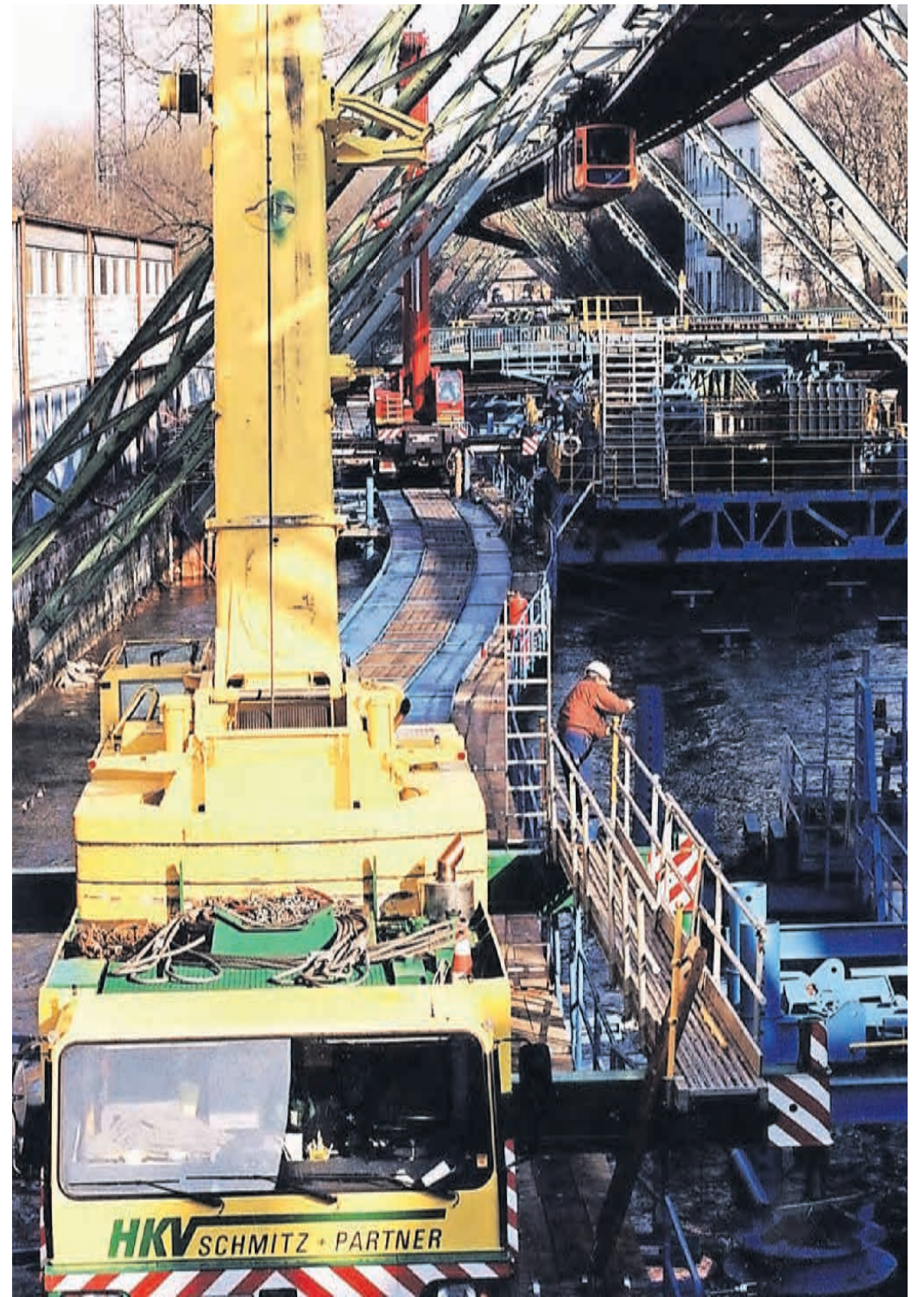
Mit aufwendigen Konstruktionen auf der Wupper wurden die Haltestellen zur Jahrtausendwende ausgetauscht.
