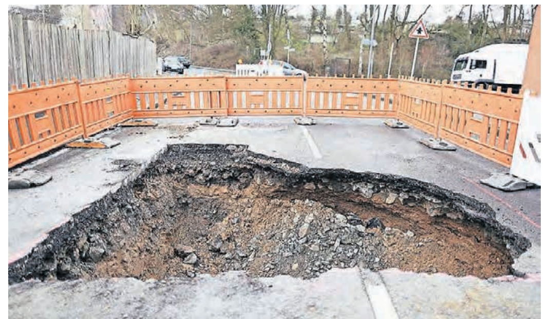
Und plötzlich war da ein Loch: Im April 2014 standen Autofahrer an der Haaner Straße in Vohwinkel vor einer rund einen halben Meter tiefen Absackung. Verantwortlich dafür ist nach Aussage der Wuppertaler Stadtwerke ein schadhafter Regenwasserkanal, der anschließend erneuert wurde. Archiv-Foto: Anna Schwartz
